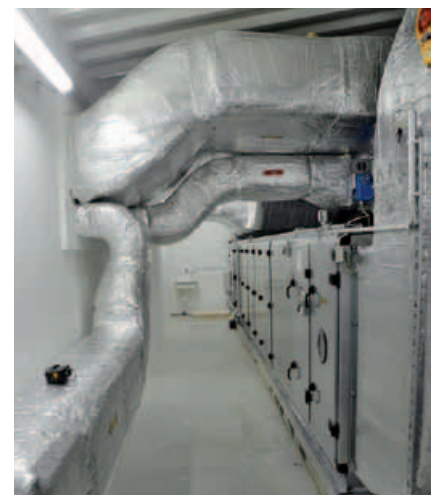
Zentrale Lüftungsanlage in einer Schule
