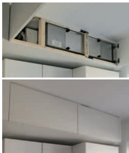
Wohnungslüftungsanlage über der Küchenzeile im Mehrfamilienhaus
