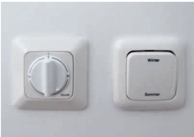
Bedienelemente der Lüftungsanlage
