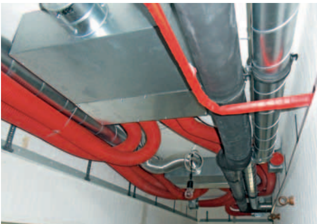
Lüftungsanlage in der abgehängten Decke (vor Verkleidung)
