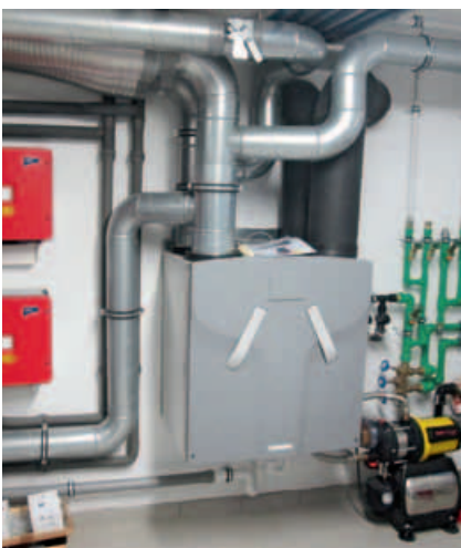
Lüftungsanlage in einem Zweifamilienhaus
