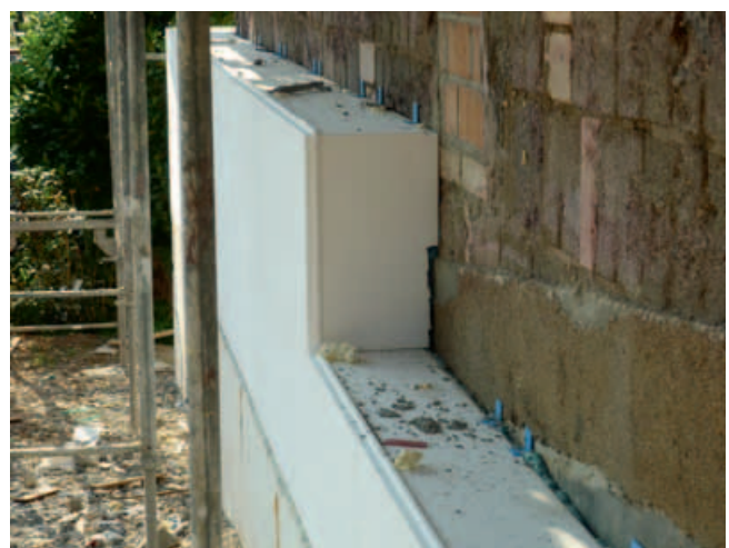
Außenwanddämmung mit einem WDVS
