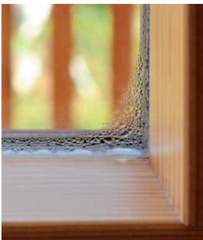
Tauwasserausfall in Höhe des Abstandhalters
